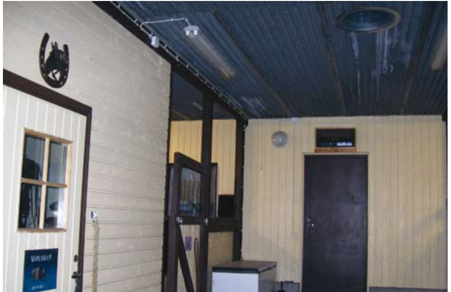
Poistoilmaputki sijoitetaan mahdollisimman keskelle rakennusta (kuvan oikeassa yläkulmassa). Vasemmalla näkyy eristetty ja lämmitetty varustehuone, johon on asennettu erillinen ilmanvaihto. Kuvan talli on kahden - kolmen hevosen pikkutalli, jossa on luonnollinen ilmanvaihto. Ilmanvaihdon toimivuuden varmistaa suuri ilmatila hevosta kohti, reilu sisäkorkeus, iso poistoilmaputki ja riittävä määrä tuloilma-aukkoja. Ilmanvaihto suunniteltiin kuitenkin jo rakennusvaiheessa niin, että poistoilmapuhallin on tarvittaessa mahdollista asentaa jälkikäteen.
